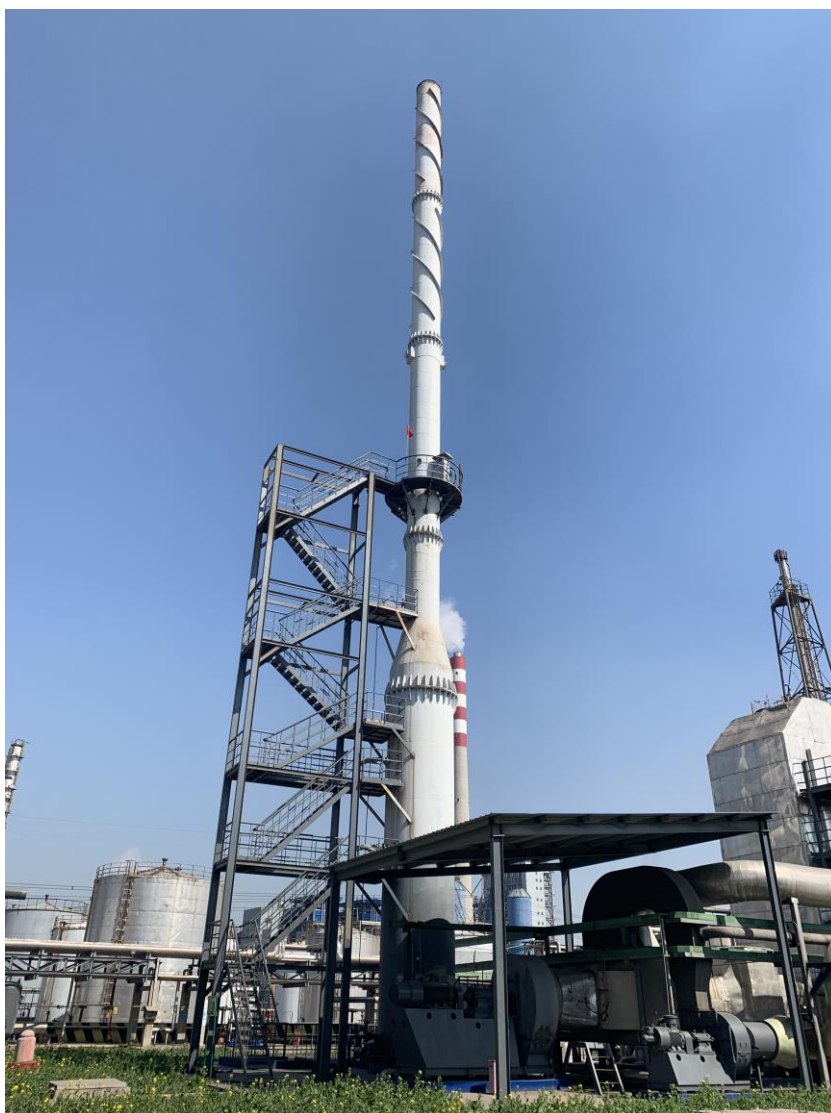
热氧化炉及排气筒
