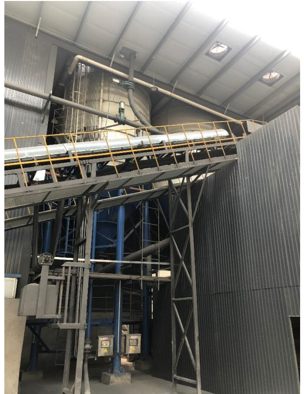
蒸压砖粉煤灰仓
