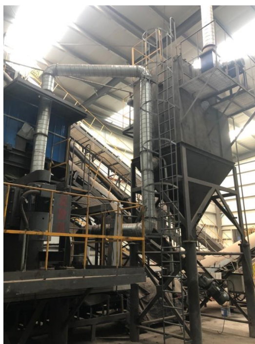
混粉工序废气处理设施
