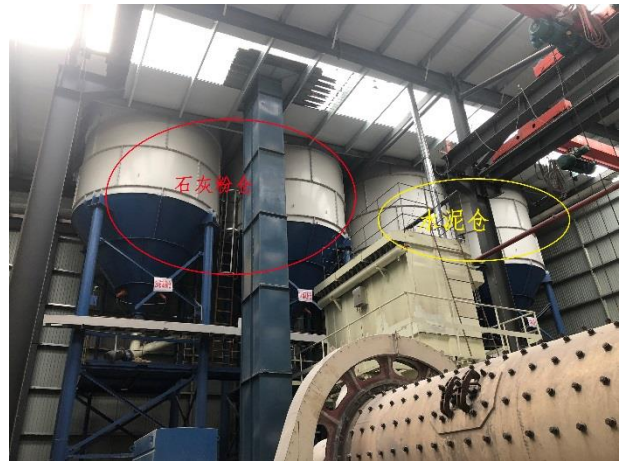
加气混凝土砌块石灰仓+水泥仓
