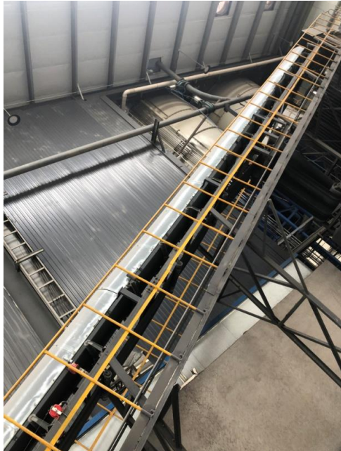
输送皮带系统加盖
