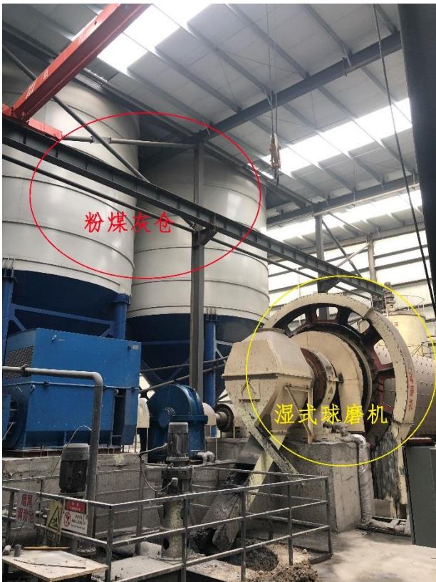
加气混凝土砌块粉煤灰仓+湿式球磨机
