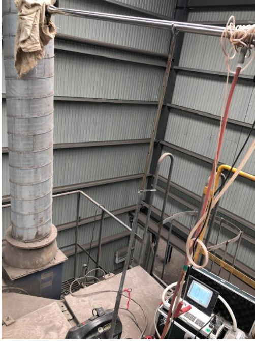
2#干粉砂浆车间废气排放口和平台
