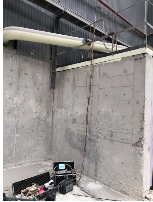
破碎车间破碎废气排放口和平台
